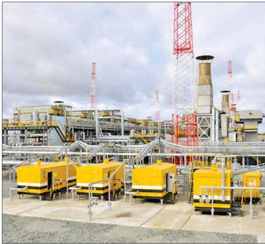
Дожимная компрессорная станция Комсомольского месторождения
